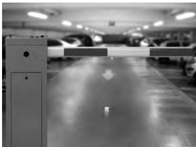
Шлагбаум, управляемый ПЧ ATV 12
