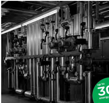
Управление насосной станцией
