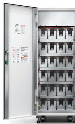
Шкаф с модульными батареями
